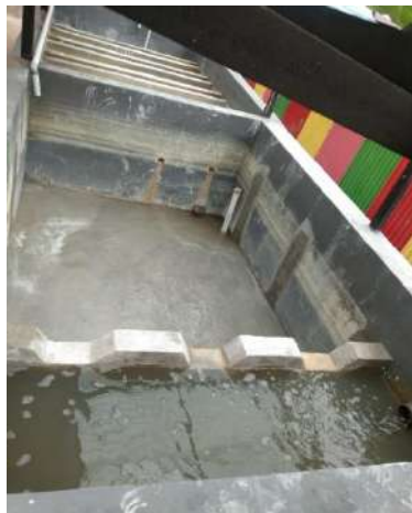
Percobaan bak pengendapan I / bak aerob (setelah perbaikan)
