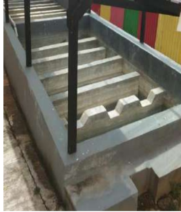
Bak pengendapan I / bak aerob (sebelum perbaikan)
